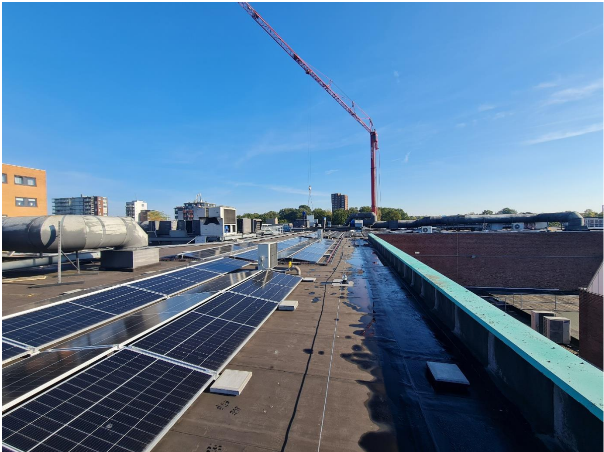
Een deel van de 476 zonnepanelen op het dak van winkelcentrum Kanaalpassage
