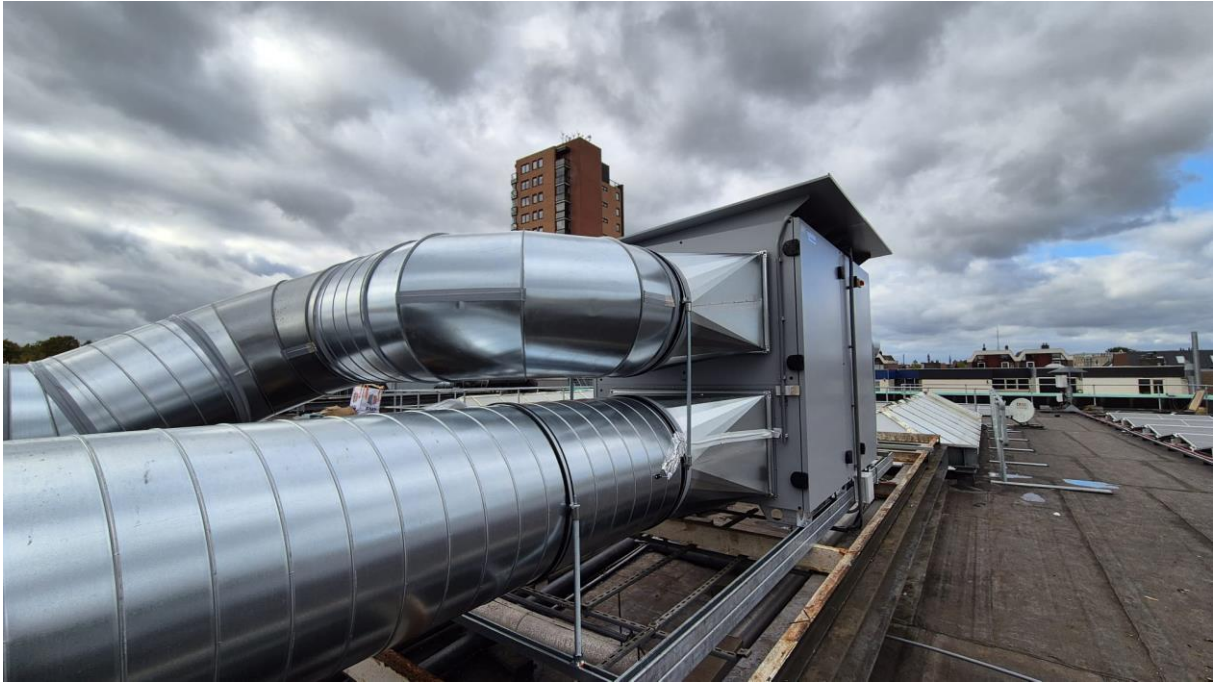
Een van de twee nieuwe luchtbehandelingskasten
